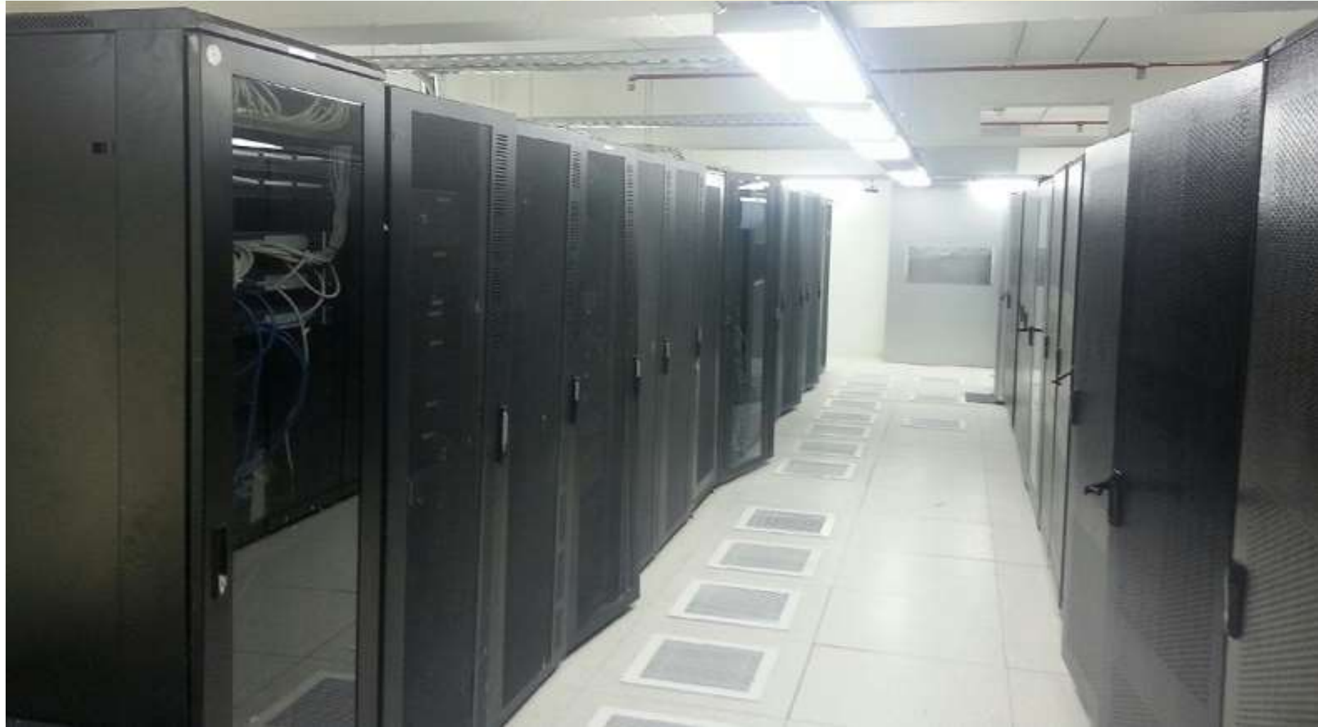
Shabakah Net Riyadh Datacenter
